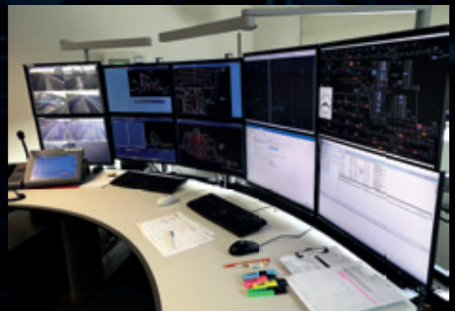
Neue Leitzentrale Hafenbahn
